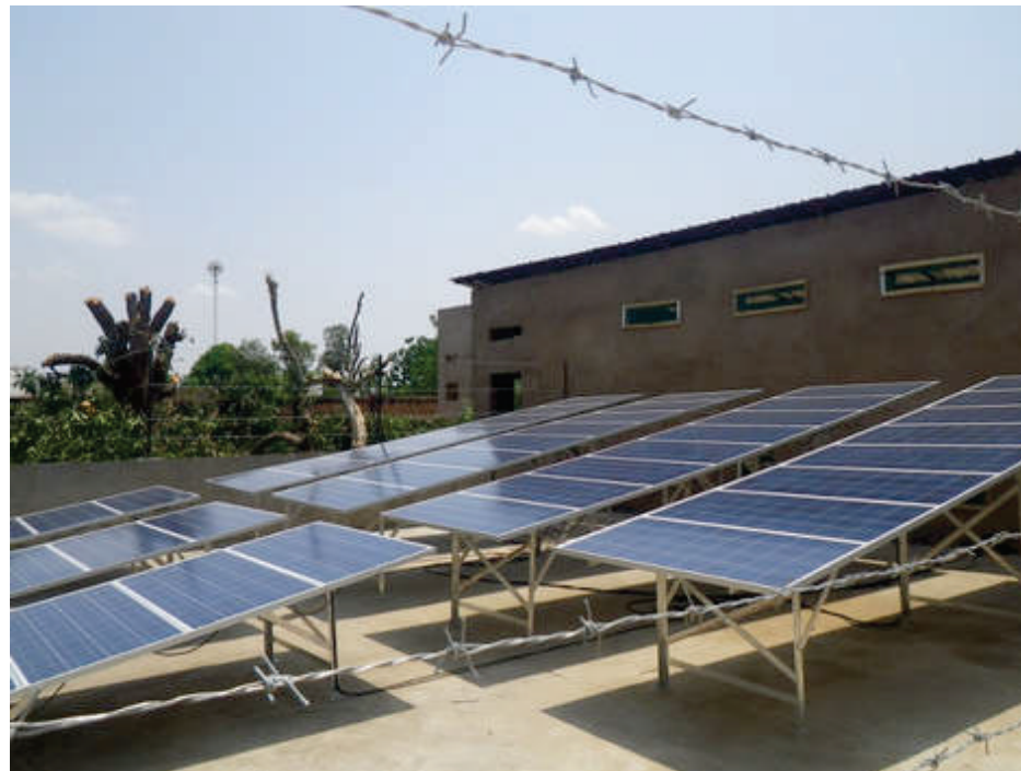
Die Photovoltaikanlage der Modellklinik in Njaba Kunda, Gambia, verfügt mit ihren 44 Modulen über eine
