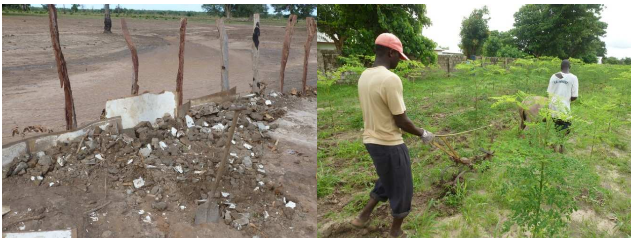
Abb. 12: Erdwall gegen eindringendes Wasser und Arbeiter beim Untermischen des Grases Quelle: eigene Darstellung
